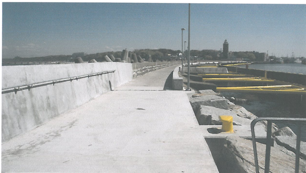
Fot. 4: połączenie starego i nowego falochronu wschodniego w Kołobrzegu; 10.05.2011 r. autor: mgr inż. Adam Szymański
